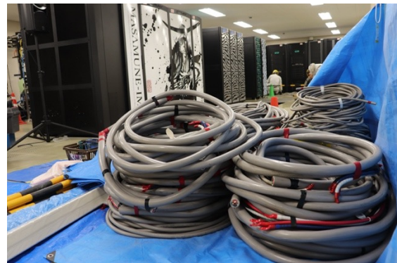
切断された電源ケーブル（10月1日）
